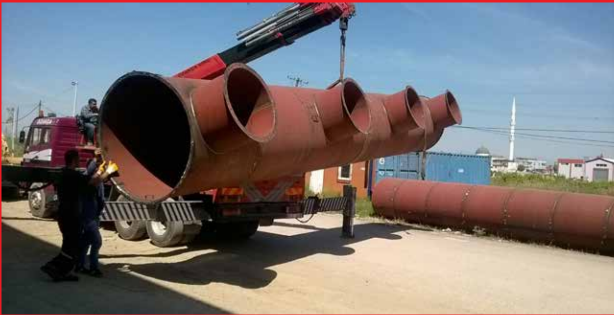
Demir Çelik Fabrikası Sıcak Gaz Borusu
